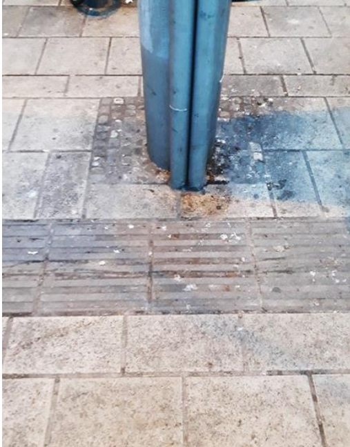
Abbildung 4: Stütze mit zu geringem Abstand zu einer taktilen Bodeninformation
