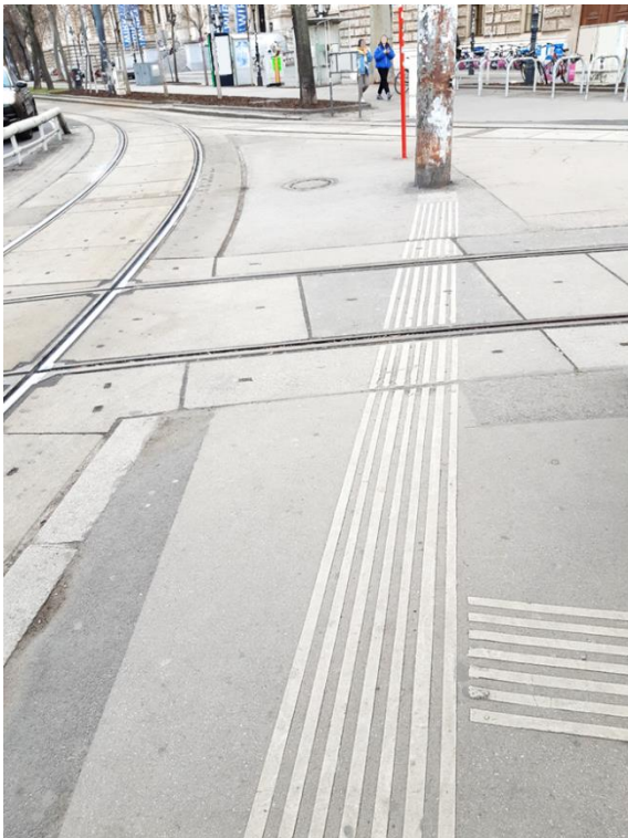
Abbildung 7: Gefahrenquelle im Bereich taktiler Bodeninformationen beim Schottentor
